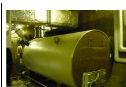
給油用ペレットボイラー
