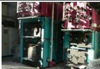
2基並んだ木質チップボイラー
