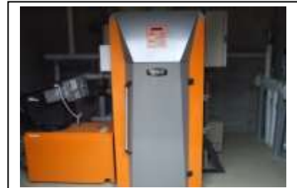
ペレットボイラー
