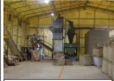
ペレット製造設備
