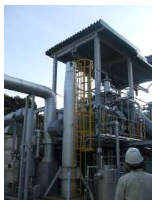
バイオマス流動層ガス化発電設備
