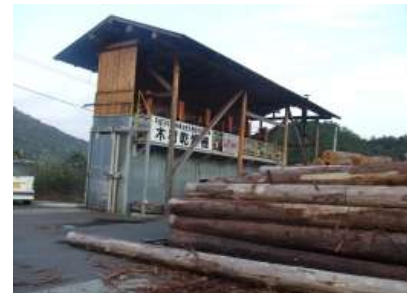
発電の蒸気を利用した木材乾燥機
