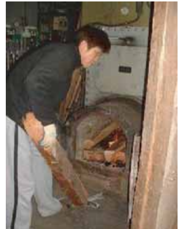
ボイラーに薪をくべる様子。大きな薪は長く燃える。
